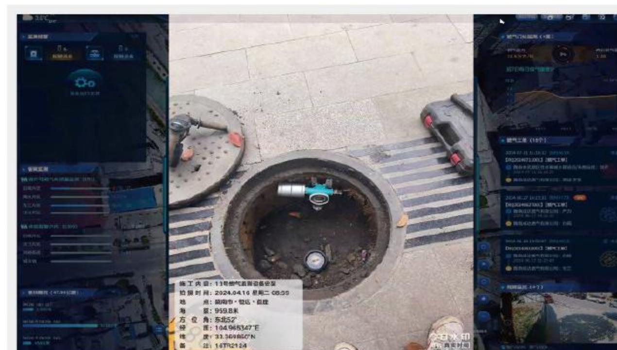
燃气管网监测软件
